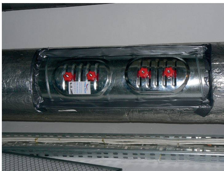
Rys. Klapy rewizyjne firmy ALNOR zamontowane podczas czyszczenia instalacji wentylacyjnej przez Vita-Vent
